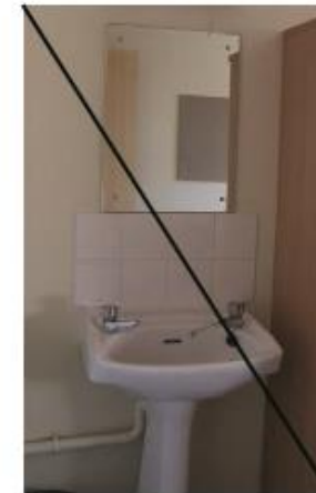
Плохо Раковина с пьедесталом. Фартук из плитки
